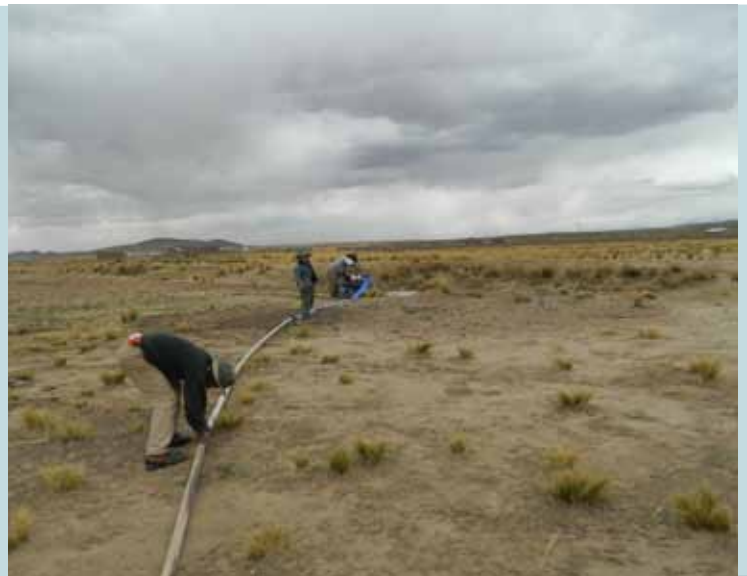
Sistema de conducción por tubería
