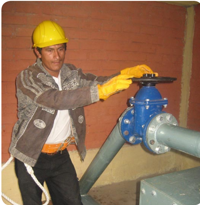
Operador maniobrando la válvula
