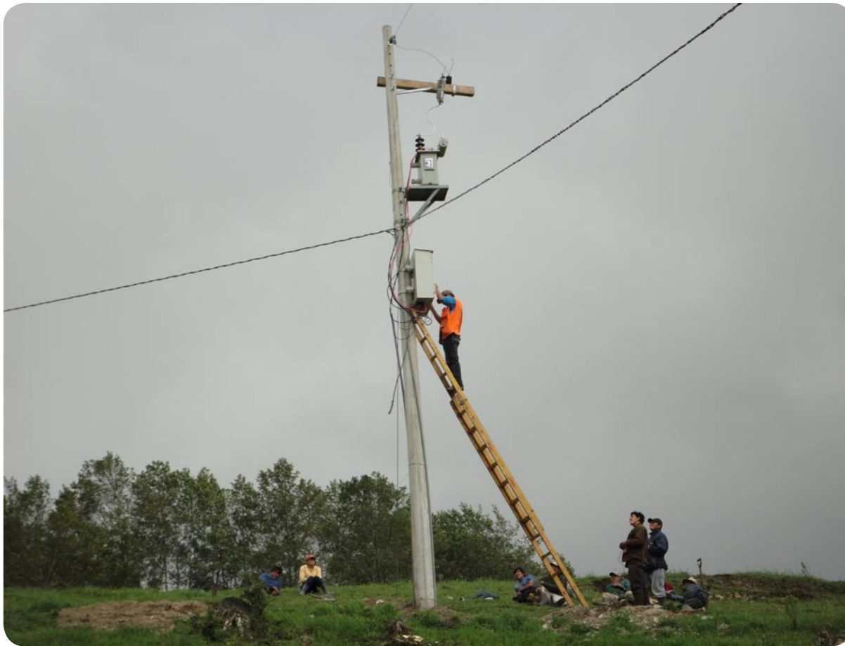
Red eléctrica de media tensión
