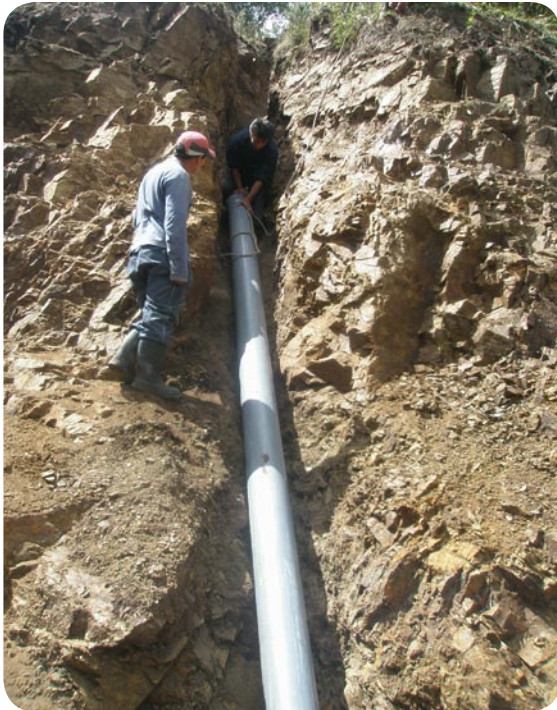
Tubería de pvc
