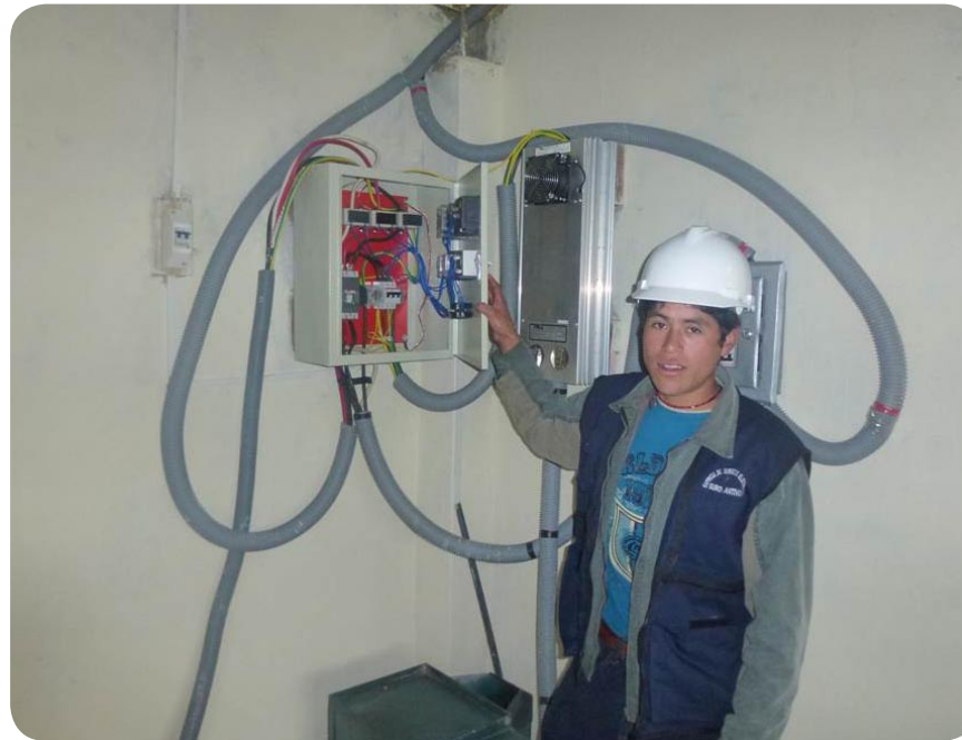
Operador abriendo el tablero
